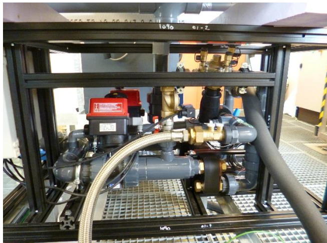
Vue de profil : arrivée eau froide
