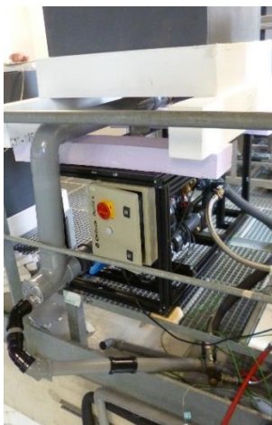
Vue arrière : évacuation des eaux de douches et armoire électrique
