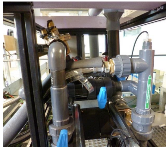
Vue avant : entrée eau froide (partie gauche) et sortie eau préchauffée (partie droite)
